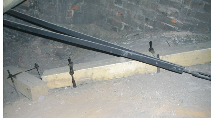
Obr. 8 Kostel Nanebevzetí Panny Marie v Opavě. Jiný příklad zajištění žeber klenby ocelovými kotvami uchycenými kolem roznášecího dřevěného trámku položeného na rub klenby. Foto: Milena Hauserová
