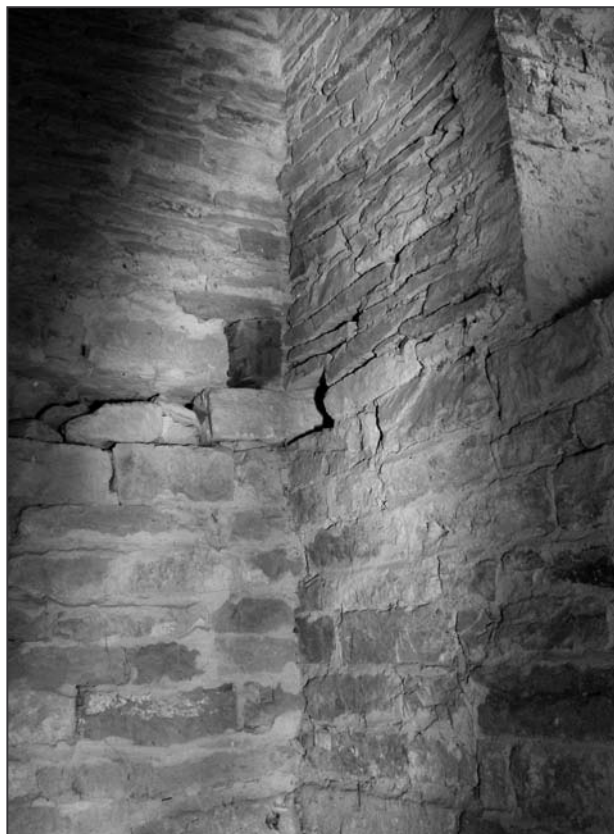
Obr. 8: Vysoký Újezd nad Dědinou (okr. Rychnov nad Kněžnou), kostel sv. Jakuba Většího. Rozhraní mezi románským kvádrovým zdivem a pozdější konstrukcí z lomového kamene ve druhém patře věže (foto M. Falta 2010).
