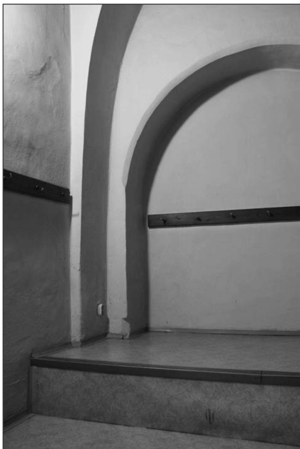
Obr. 12: Čelákovice (okr. Praha-východ), kostel Nanebevzetí Panny Marie. Odlehčující arkáda západní zdi lodi v úrovni empory (foto M. Falta 2010).
