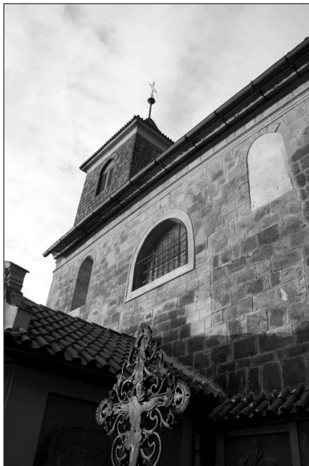
Obr. 4: Čelákovice (okr. Praha-východ), kostel Nanebevzetí Panny Marie. Pohled na jižní fasádu kostelní lodi s dvojicí románských oken od jihovýchodu (foto M. Falta 2010).
